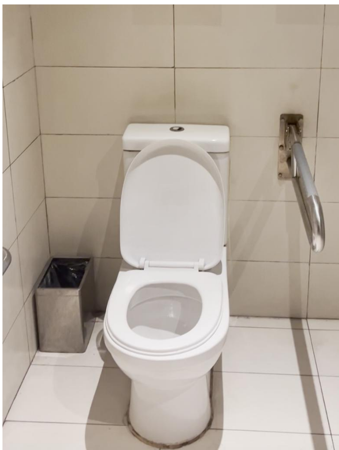
图1 角门西站无障碍厕所坐便器及扶手
