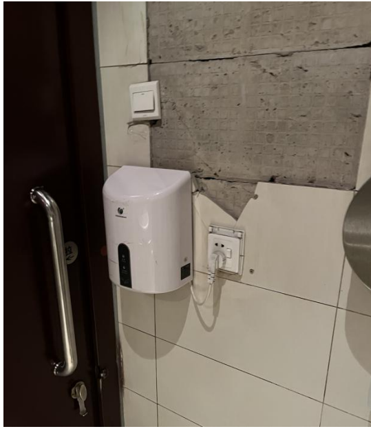
图 2 北京南站无障碍厕所的墙面瓷砖脱落
